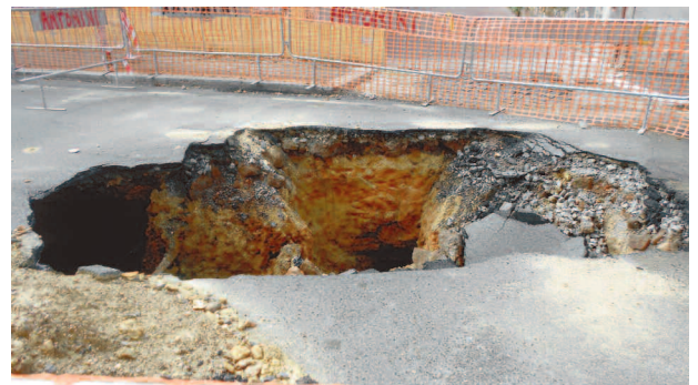
Fig. 16 - Voragine di Via Bartali, Monteverde Vecchio. - Via Bartali sinkhole, Monteverde Vecchio.
