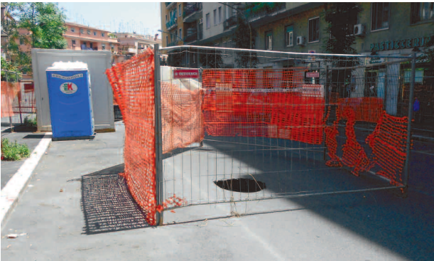
Fig. 14 – Voragine presso Via Genzano, zona largo Colli Albani-Via delle Cave. - Via Genzano sinkhole, Colli Albani- Via delle Cave area.
