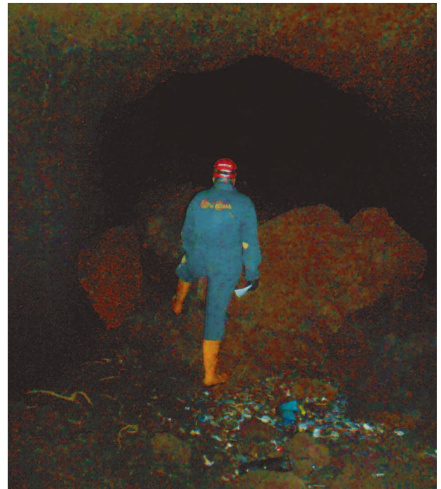
Fig. 15 – Eventi di crollo presso i sotterranei di Via Columella, Quadraro. - Events of collapse in the underground of Via Columella, Quadraro district.
