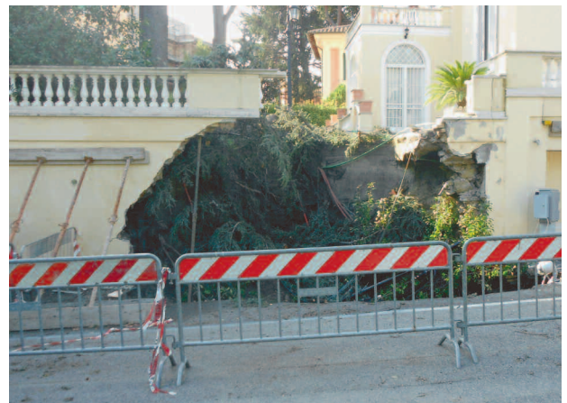
Fig. 10 - Sprofondamento presso Piazza Albina, Aventino. - Piazza Albina sinkhole, Aventino.
