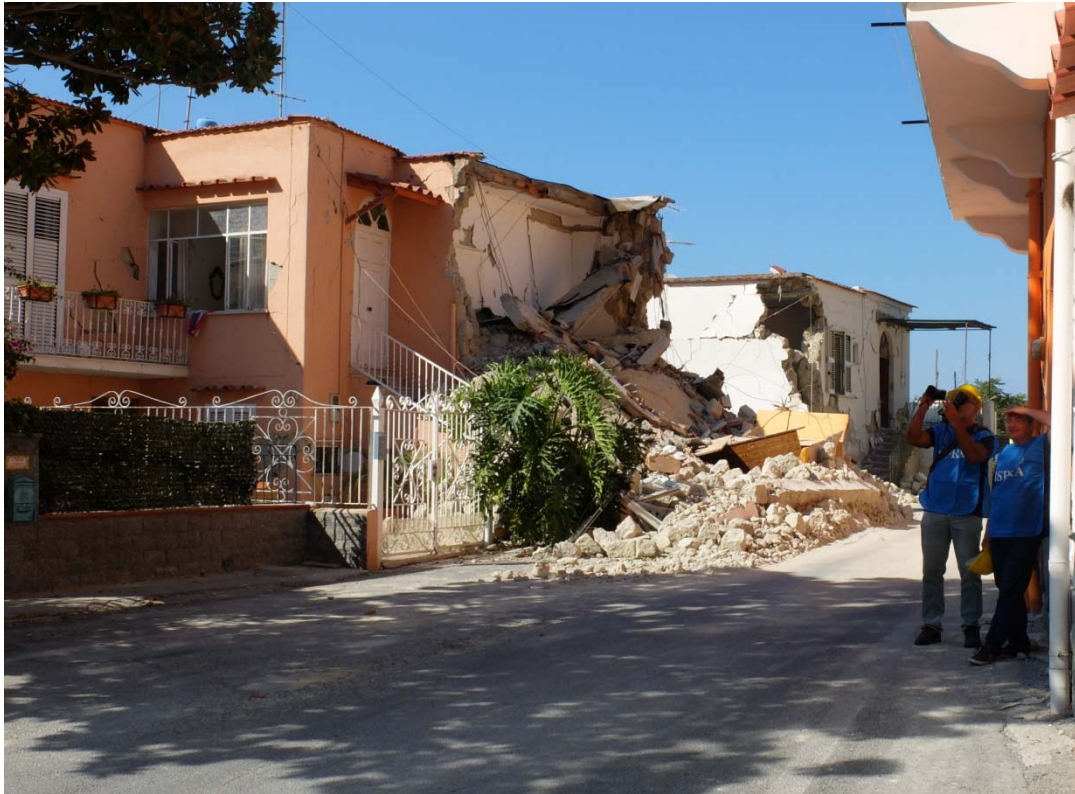
Figura 18 - Case realizzate in muratura a sacco con blocchi di tufo, fortemente danneggiate e crollate a seguito del sisma.
