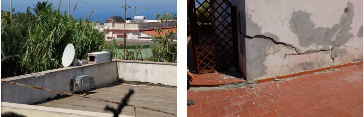
Figura 28 - Crollo dei comignoli e cedimento di fondazione in alcune abitazioni di realizzazione/restauro recente, in località Fango.
