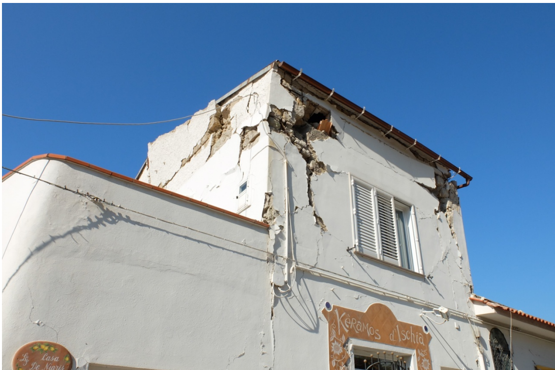
Figura 23 - Casa in muratura fortemente danneggiata; la struttura è costruita in materiale lapideo composito, sia per forma che dimensioni ed è stata oggetto in passato di interventi di miglioramento strutturale, come mostrano i due tiranti presenti agli angoli, sotto la copertura.
