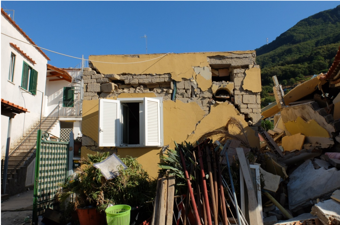
Figura 22 - Struttura in blocchi di tufo squadrate; da notare la ridotta presenza di malta e l'assenza di vincoli tra muratura e solaio.
