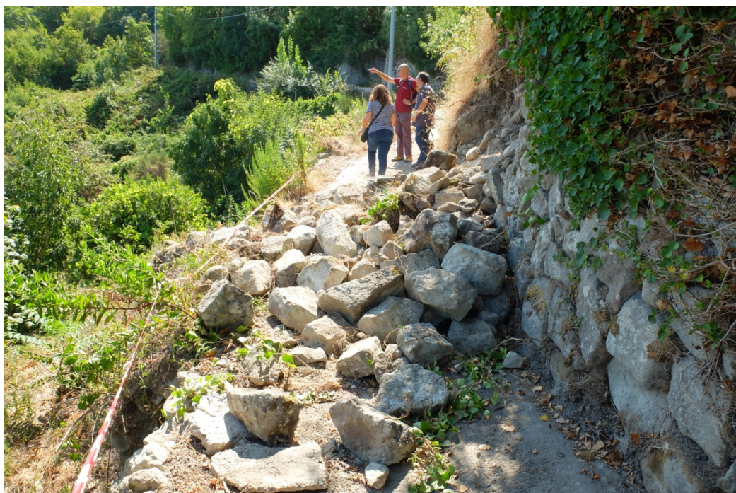
Figura 15 - Tratto di muro a secco crollato al WP326; le pietre bloccano la strada che conduce ad alcune abitazioni.
