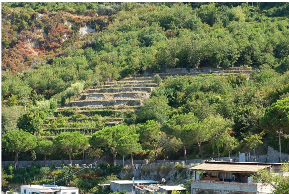
Figura 16 - Muri a secco crollati nel settore collinare a monte della strada di collegamento tra Fango e Majo (WP311). I muri sono crollati per ampi settori e dissestati e allentati nei settori adiacenti, ciò rende poco efficace la loro azione di regimazione idrologica e stabilizzazione geomorfologica.
