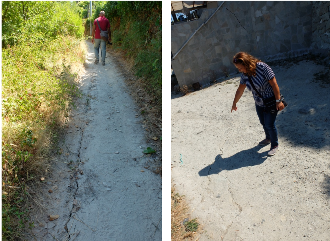
Figura 9 - A sinistra, frattura lungo il sentiero delle fumarole a tergo di un muro di sostegno a secco (WP328; 329); a destra, frattura su terrapieno contenuto a valle da un muro di sostegno in muratura, in parte crollato; la frattura si segue per una decina di metri ed interessa anche il muro visibile sullo sfondo della foto. (WP334).
