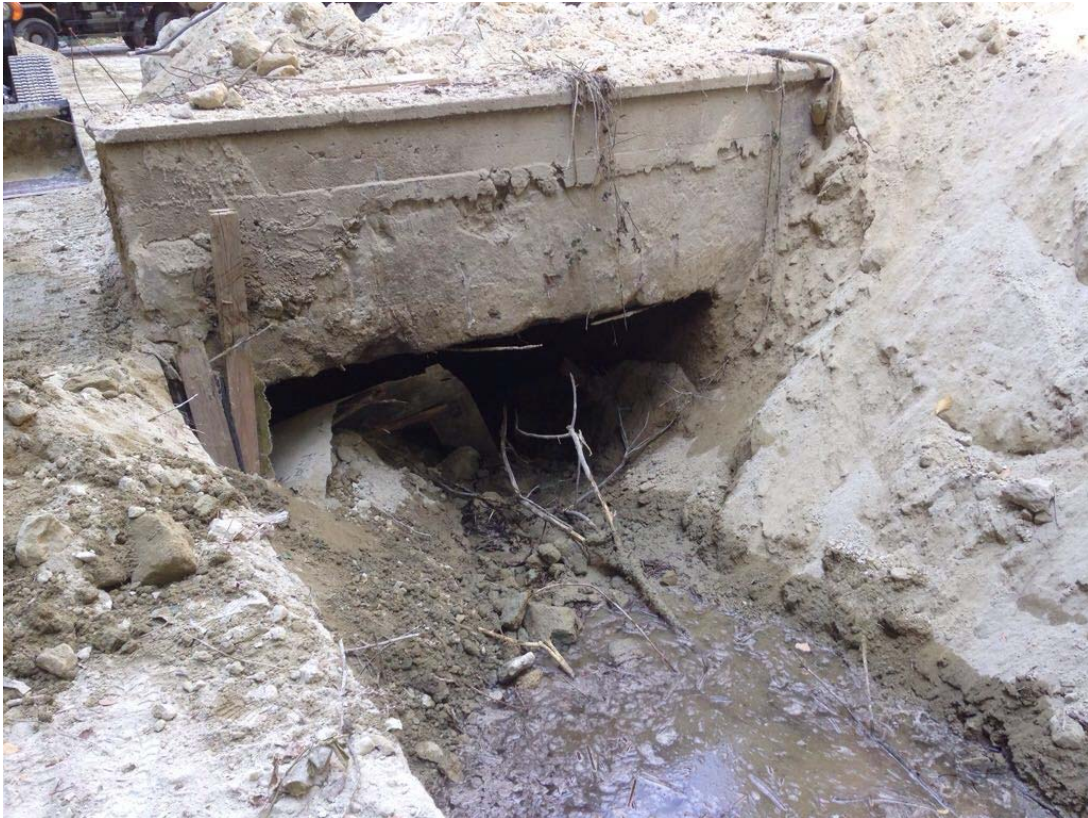
Figura 14 - Scatolare in calcestruzzo parzialmente ostruito dalla frana verificatasi lungo la scarpata del vallone Senigallia.
