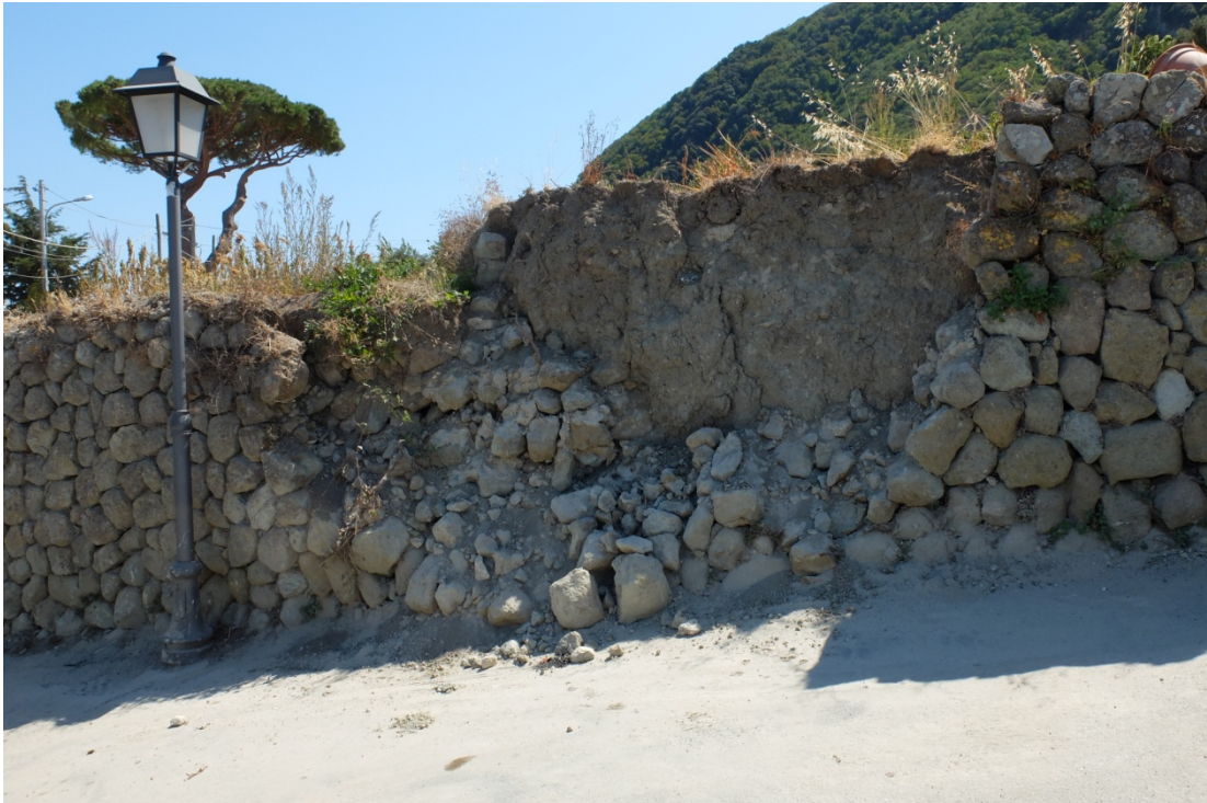
Figura 17 - Tratto di muro a secco presente sul lato di monte di via Crateca (WP333); il materiale lapideo ha ostruito la strada ed è stato poi rimosso. Si può osservare il materiale terroso non più protetto dal muro, che in caso di precipitazioni, potrà facilmente essere eroso e portato a valle.
