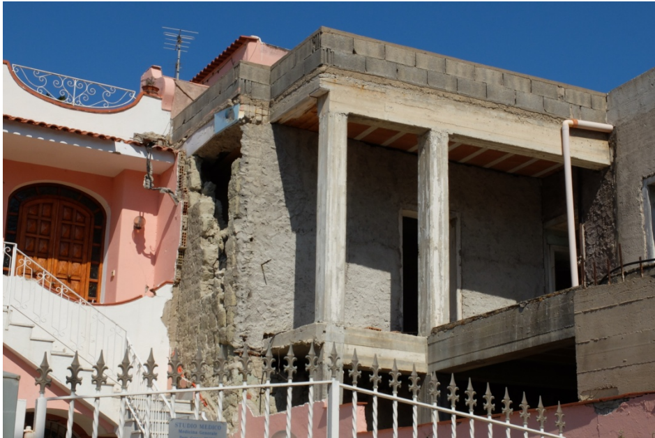
Figura 24 - Ampliamenti e tentativo di miglioramento strutturale di un edificio posto lungo via Montecito; si nota l'accostamento di porzioni di strutture con sovrapposizione di materiali e tecniche diverse (muratura in tufo, strutture in cemento armato).
