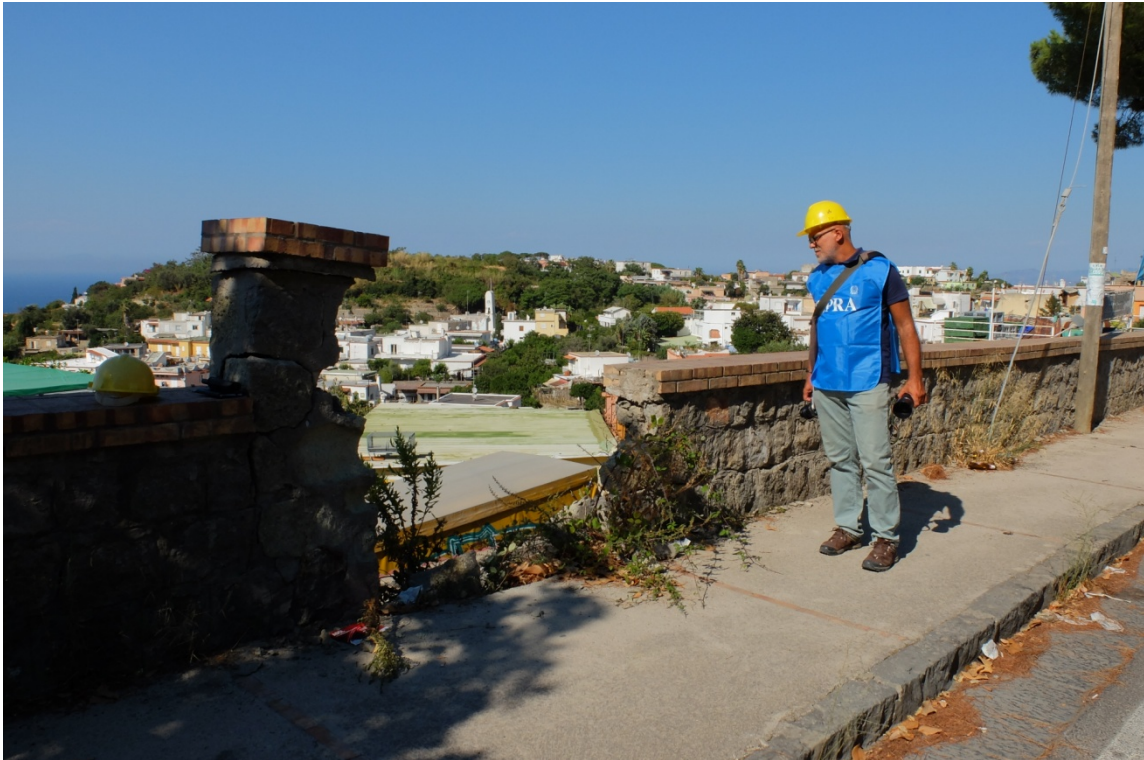
Figura 31 - Porzione di muro e scaletta crollata sul lato a valle di via Montesito (WP312).
