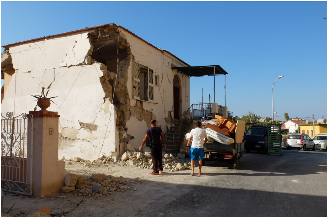
Figura 19 - Abitazione realizzata in muratura a sacco, parzialmente crollata per effetto del terremoto.
