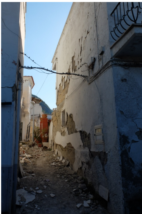
Figura 27 - Rigonfiamento della muratura e distacco dell'intonaco su edifici presenti nel centro abitato di Majo.
