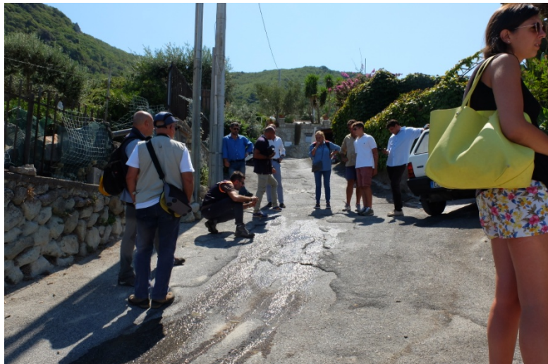
Figura 32 - Fuoriuscita di acqua dalla condotta idrica presente lungo via Crateca, a seguito di rottura in corrispondenza di una frattura (WP287; WP320).
