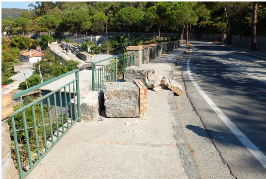
Figura 30 - Muretti presenti sul lato a valle di via Montecito, scollati alla base e ribaltati verso monte (WP310)
