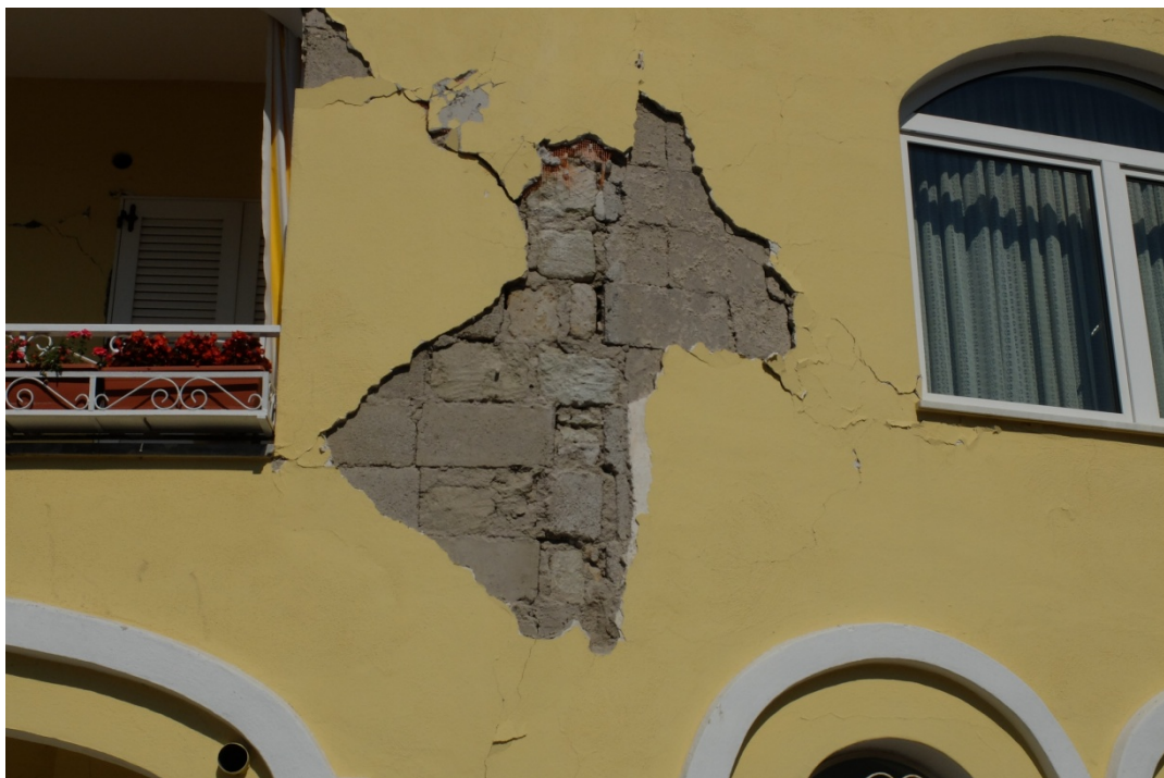
Figura 21 - Edificio situato lungo via Montecito, danneggiato dal terremoto. Le murature sono soltanto accostate e non ammassate ne vincolate.
