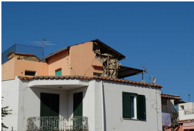
Figura 25 - Sopraelevazione di un edificio presente lungo la strada che da Majo conduce a Bagni. Si nota nella porzione crollata a seguito del terremoto la presenza di un'impalcatura in legno inglobata nella muratura.
