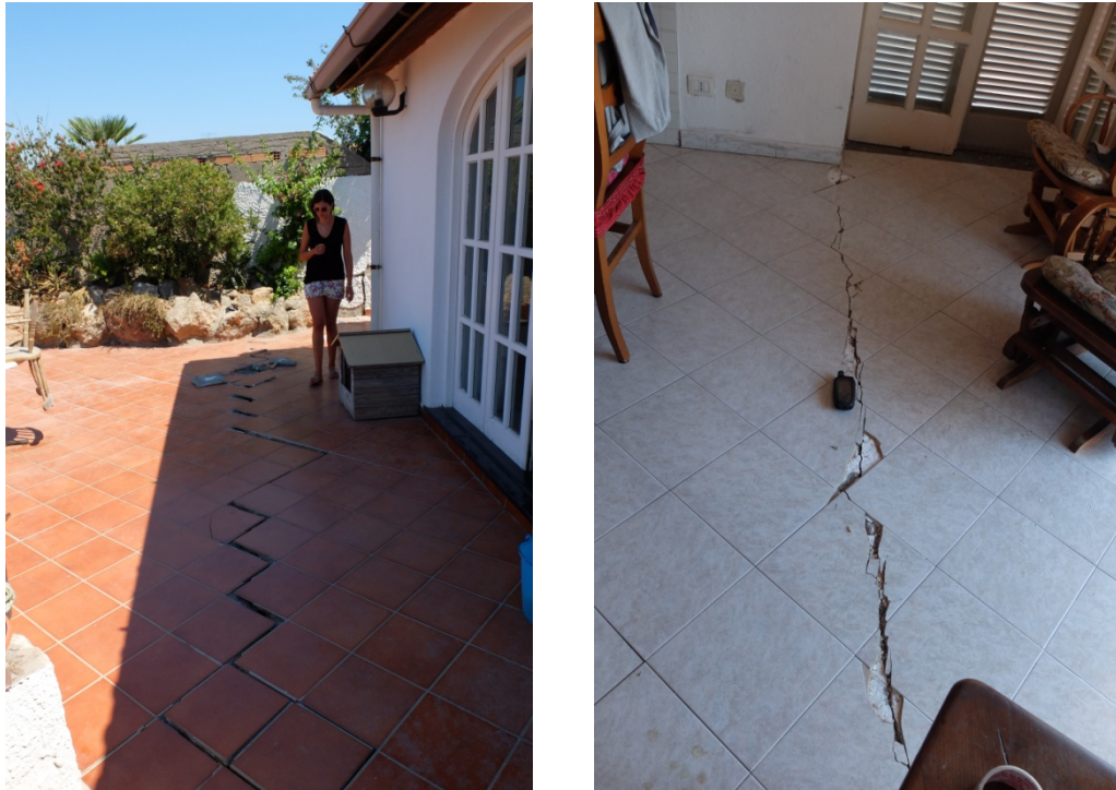
Figura 7 - Fratture presenti sul terrazzo e all'interno dell'abitazione sita ad W di via Crateca. Le fratture si localizzano lungo gli svincoli tra terrapieni e porzioni di fabbricato realizzati in tempi successivi.
