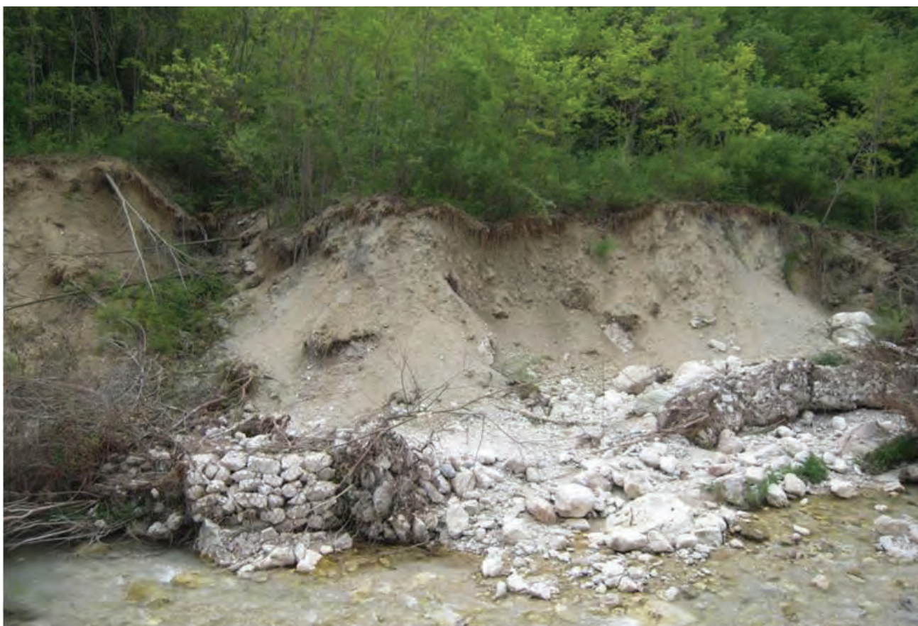
Fig. 18 – Fenomeni di erosione di sponda lungo l'alveo del T. Scura causati dall'evento alluvionale del dicembre 2010. - Erosion of bank along T. Scura riverbed, provoked by December 2010 alluvial event.
