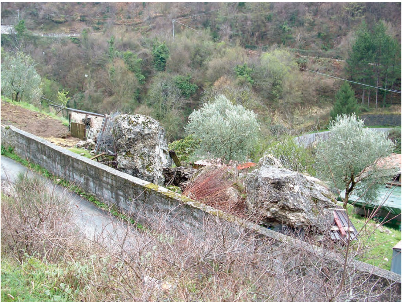
Fig. 25 – Massi del volume di alcuni metri cubi crollati lungo la strada in località Guardiolo (Antròdoco). - Boulders with a volume of some meter cube fallen on the road (Antròdoco).
