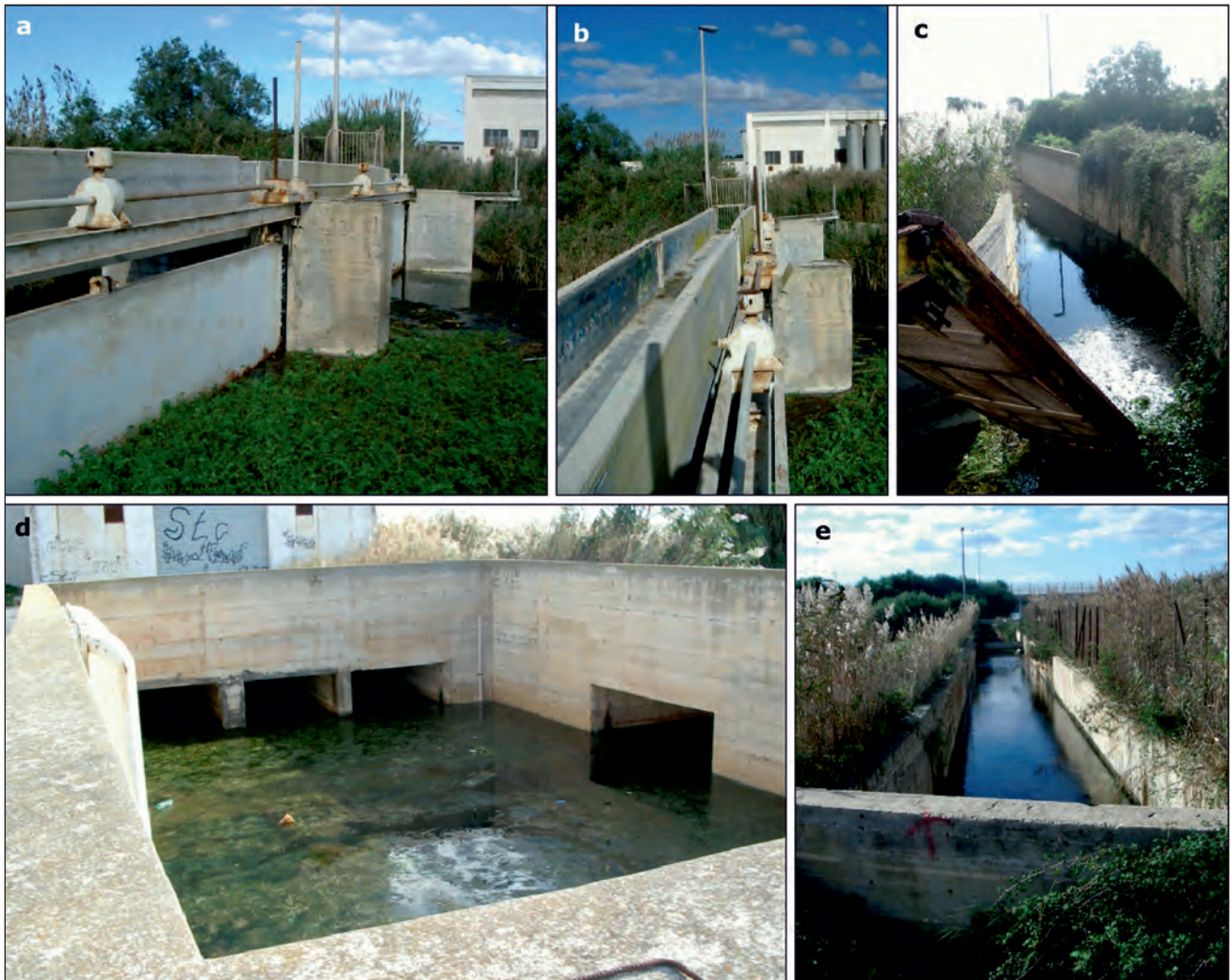
Fig. 4.98 - Foto delle opere di captazione già eseguite alla sorgente Chidro: a) paratoie di intercettazione delle acque sorgentizie; b) particolare della testa delle paratoie; c) canale di derivazione delle acque sorgentizie nei pressi della vasca di carico; d) vasca di carico; e) canale di scarico dell'impianto di sollevamento che si raccorda a valle con il fiume Chidro. Tutte opere oggi solo deturpanti il paesaggio.
