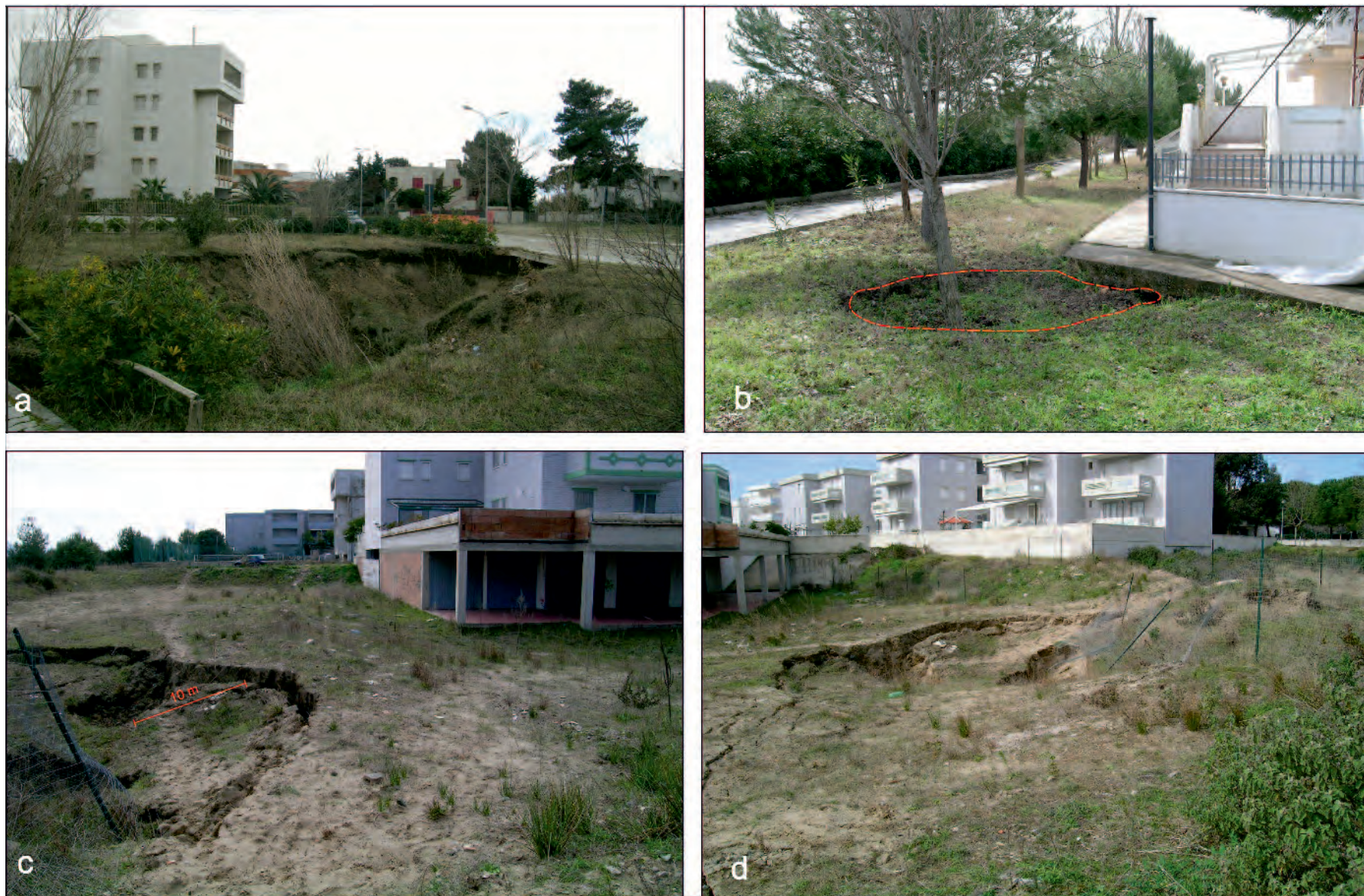
Fig. 13.33 - Sinkhole nei pressi degli insediamenti abitativi di Marina di Lesina: a) Sinkhole (15 metri di diametro) rilevato al margine del condominio “Tremiti B”; b) Sinkhole rilevato il 10 Marzo 2005 al margine del muretto di recinzione del condominio “Levante”; c) Sinkhole in progressione che ormai sta per interessare il margine di una struttura; d) dissesto geologico al margine di alcuni condomini in via Plutone. - Sinkholes near the built-up area of Marina di Lesina: a) a sinkhole of 15 metres in diameter at the edge of the condominium “Tremiti B”; b) sinkhole detected on 10 March 2005 at the edge of the fencing wall of condominium “Levante”; c) a progressively extending sinkhole which is on the way to affect the edge of a house; d) geological instability at the edge of some condominiums in Via Plutone.
