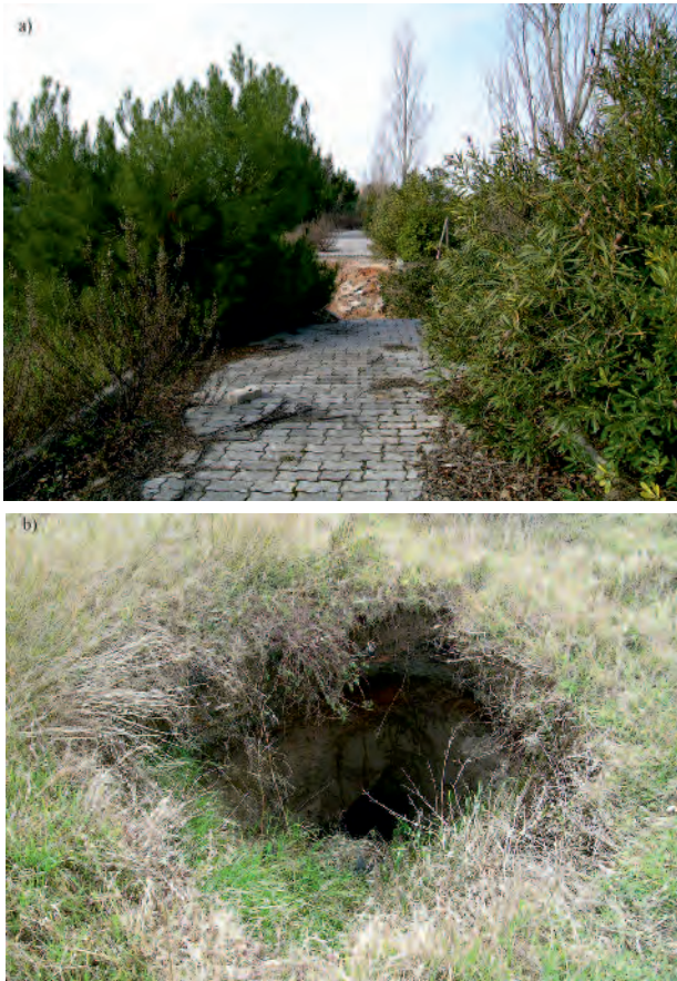
Fig. 13.36 - Esempi di sinkhole: a) viale dissestato a causa della presenza di un sinkhole; b) tipico (cilindrico) del diametro di circa 3 m, e tanto profondo da far scorgere sul fondo l'acqua a -10 m circa dal p.c..
