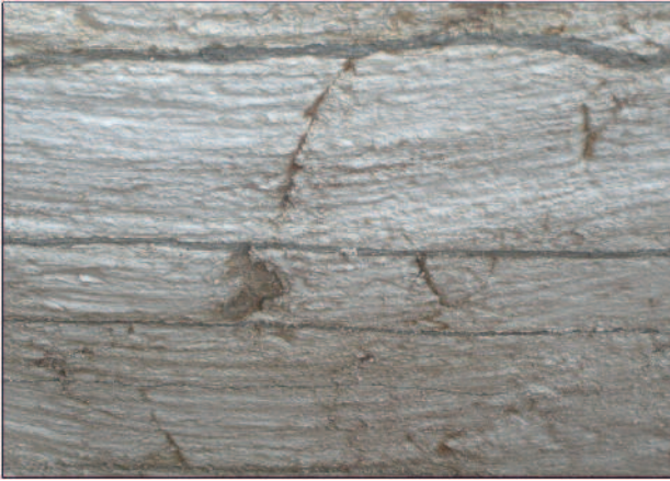
Fig. 25.6 - Parcheggio in Piazza Cesare Battisti: miscela cementizia tradizionale penetrata nei giunti di strato del calcare. - Parking lot in Cesare Battisti Square: grouting penetrated into the bedding planes of the limestones.
