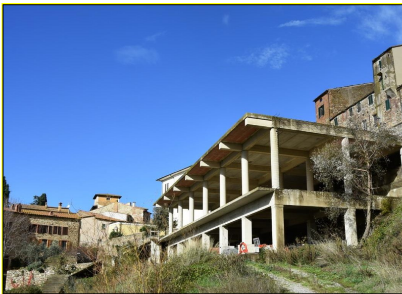
Figura 3.19 Esempio di opere non conformi alle finalità di difesa del suolo: realizzazione di un parcheggio multipiano inserita in un intervento di consolidamento del versante (intervento con procedura di revoca in itinere).
