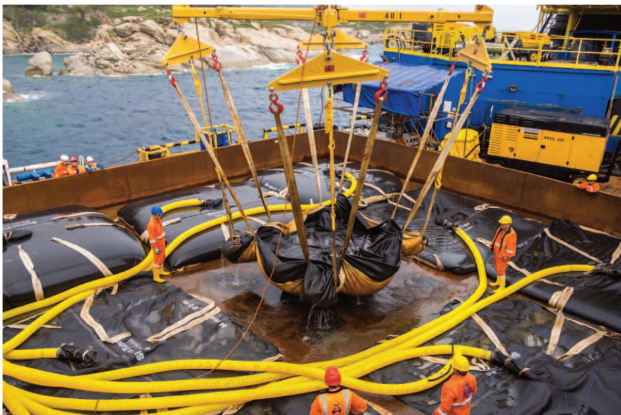
Figura 8.14: Alcuni dettagli dell'impianto di vaglio e separazione del sedimento raccolto.
