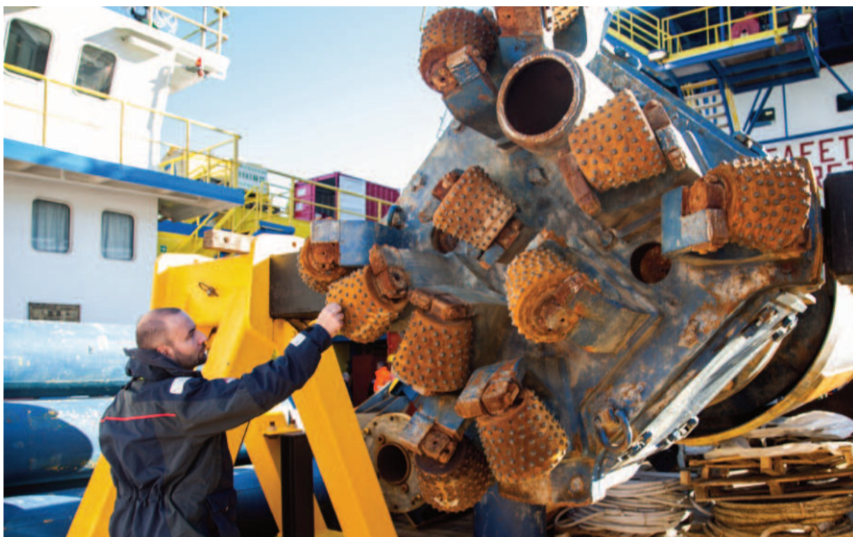
Figura 6.7: La testa di perforazione utilizzata per creare gli alloggiamenti delle gambe delle piattaforme nel substrato granitico.
