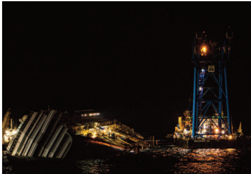
Figura 6.1: Nel cantiere le operazioni proseguivano giorno e notte e si interrompevano solo in occasione di condizioni meteo-marine avverse.
