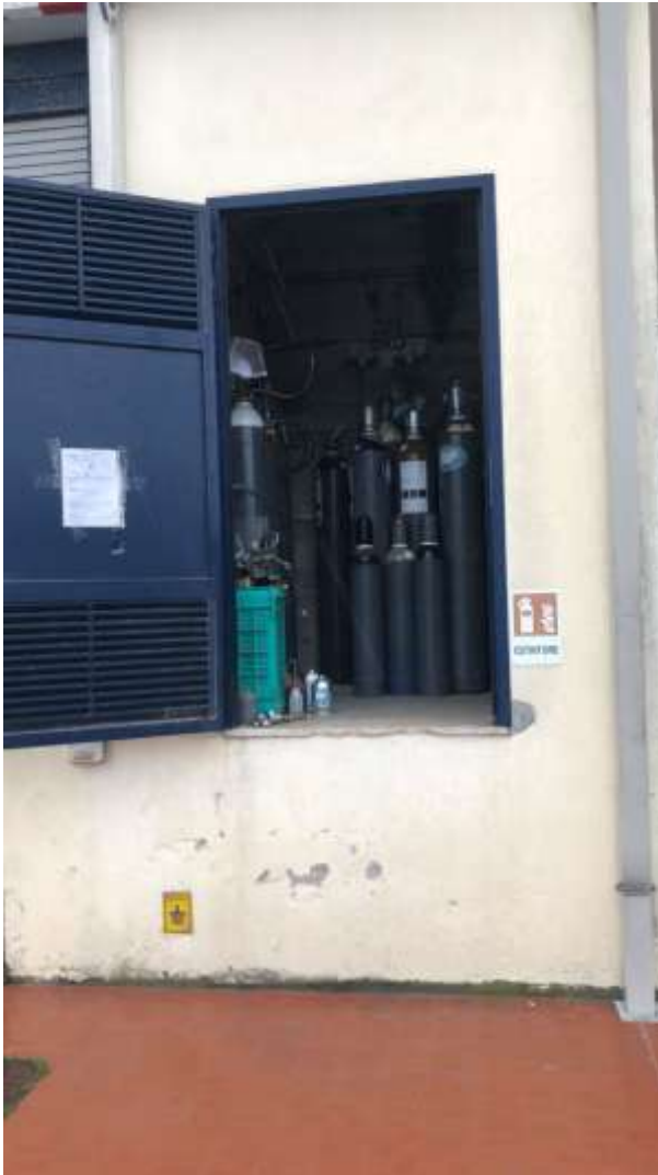
Foto 2 locale bombole sede Chioggia
