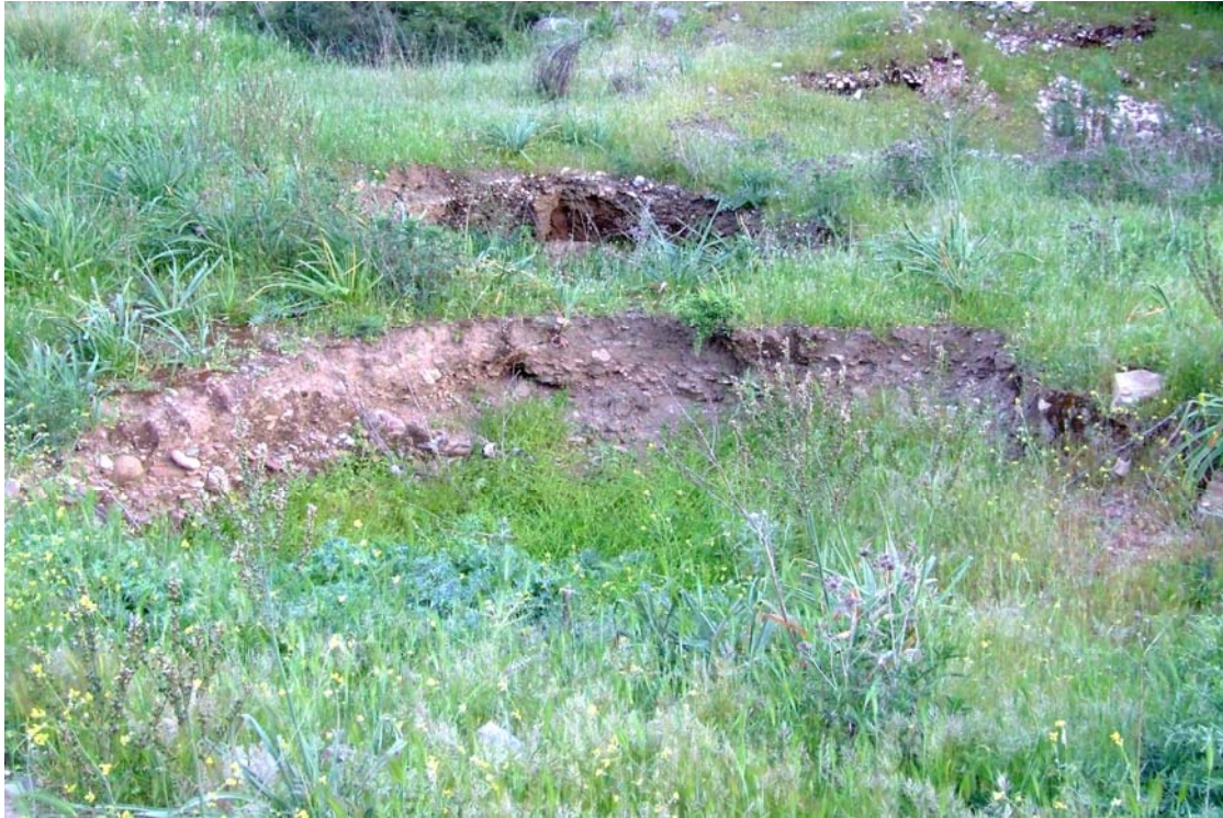
Figura 13: Sinkhole multiplo in località Cuccuru Tiria, (foto 2008).
