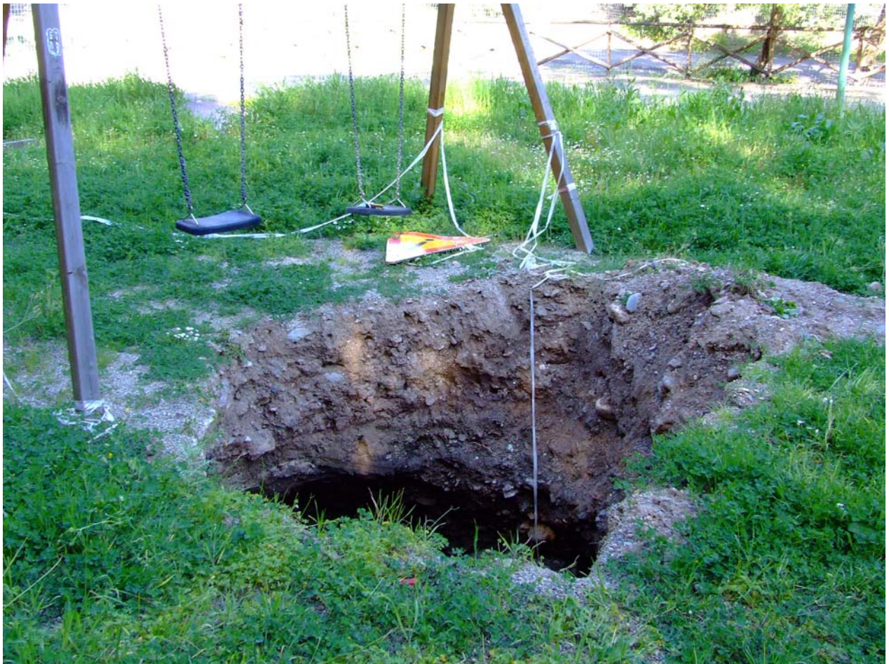
Figura 8: Sinkhole verificato nei primi mesi del 2008 nel Comune di Narcao (Sardegna Sud-Occidentale), in prossimità del parco giochi.
