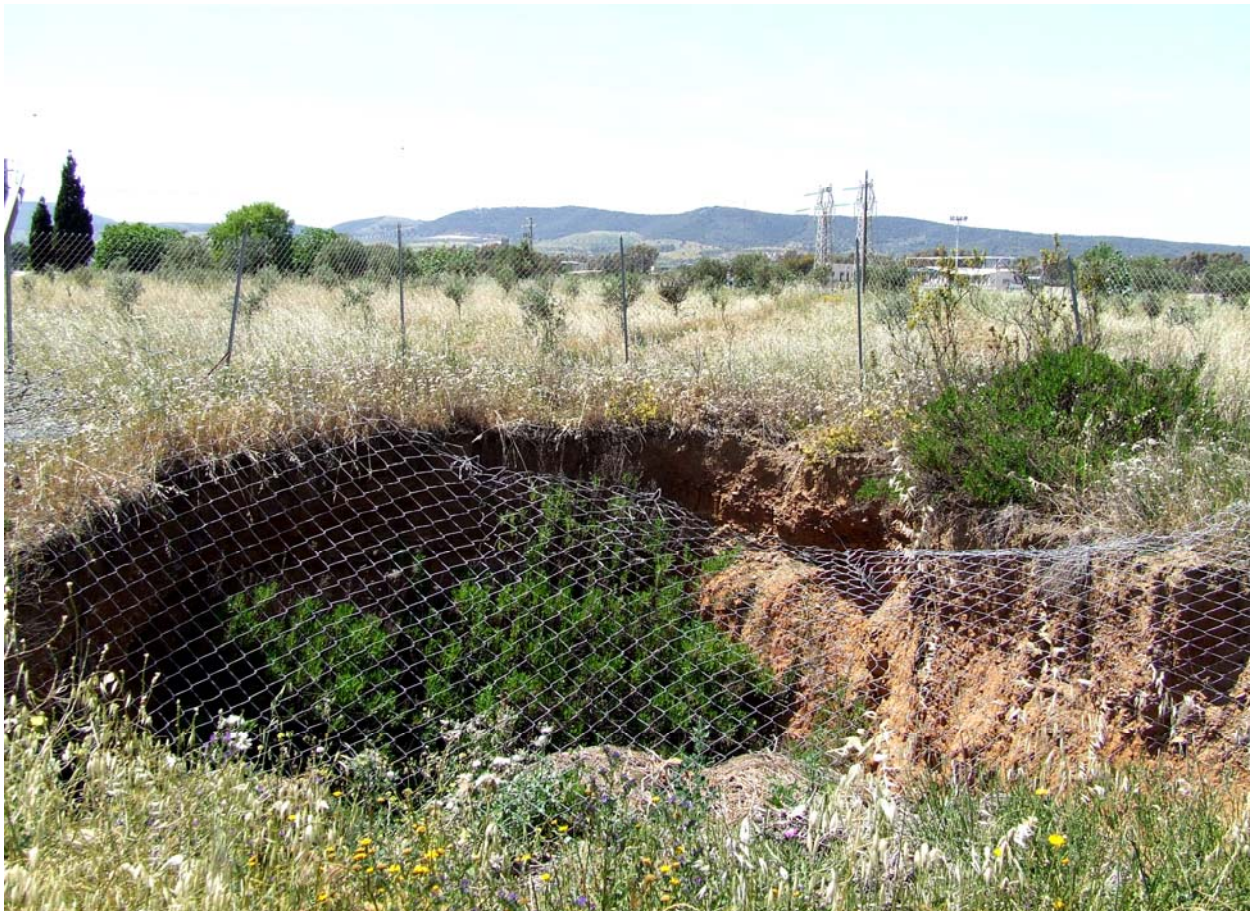
Sinkhole in località Guardia su Merti ( Sardegna Sud-Occidentale).
