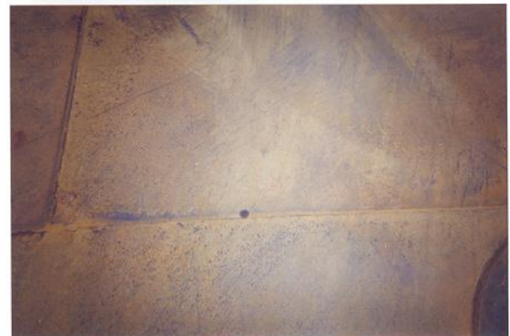
TETTO: PROVA GASOLIO; RILEVATA INFILTRAZIONE DI GASOLIO, LOCALIZZATA AL CONTOURNO DI UNA RIPRESA DIFETTOSA DELLA SALDATURA DI COMPOSIZIONE DEL TETO CENTRALE. (EFFETTUATO RIPARAZIONE E SUCCESSIVA PROVA CON GASOLIO, ED ESITO FINALE FAVOREVOLE)
