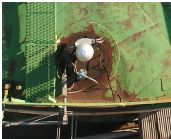
Det. 1: lamiere soggette a corrosione (zona perimetrale e connessione)
