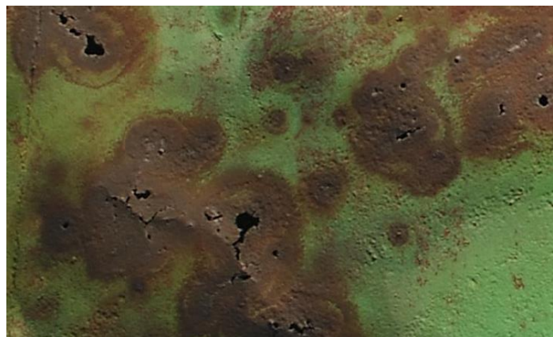
Ingrandimento zona corrosione passante
