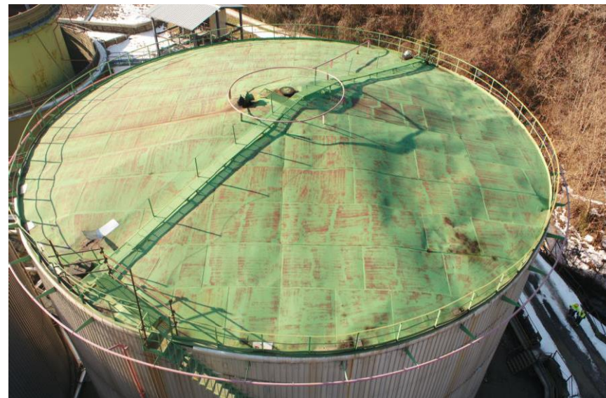
Vista zona deformata (lato sud-est)
