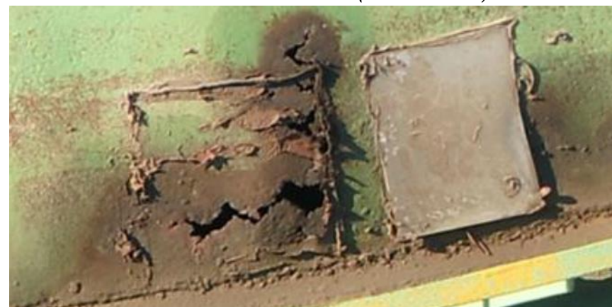
Dett. 1: corrosione passante in zona perimetrale (precedentemente tamponata)
