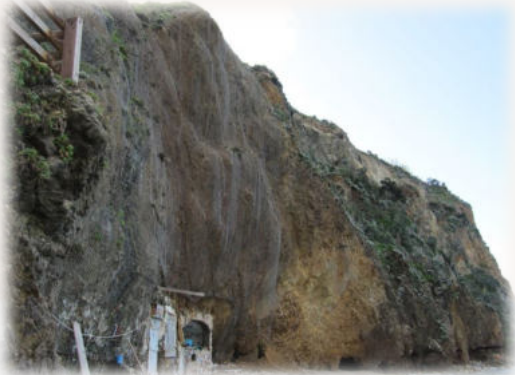
Esempi di instabilità per crollo localizzate in corrispondenza delle ialoclastiti brecciate ed alterate
