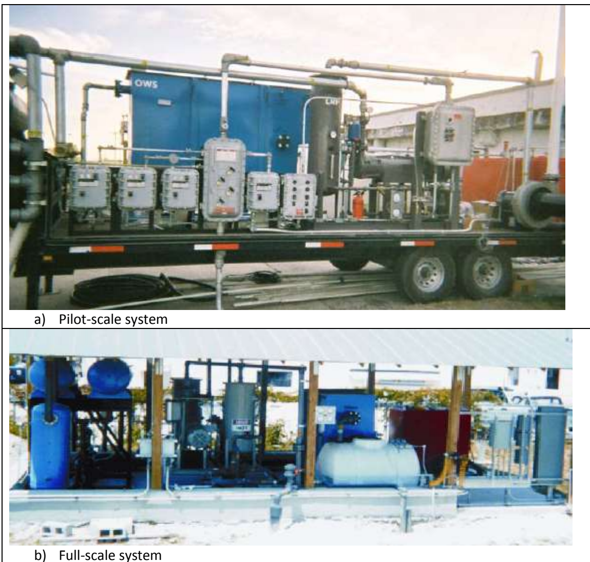
Figura 2.6.: Sistema di bioslurping installato e operativo [5]
