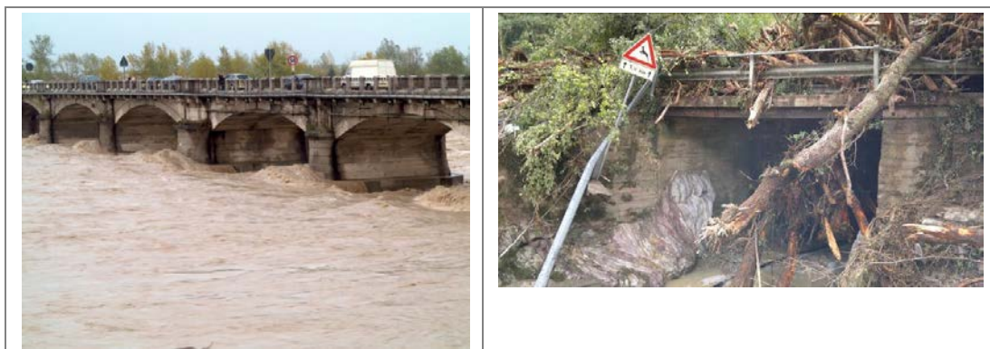
Figura A7.12 – Ponti del tipo 2: a sinistra, con pile in alveo, di sufficiente ampiezza per non causare ostruzioni nel caso di trasporto di legno non intenso (immagine tratta da http://tribunatreviso.gelocal.it ); a destra, a campata unica con impalcato di altezza teoricamente sufficiente ma con luce di ampiezza troppo ridotta con trasporto intenso di materiale legnoso (si ringrazia per foto la Provincia di La Spezia).
