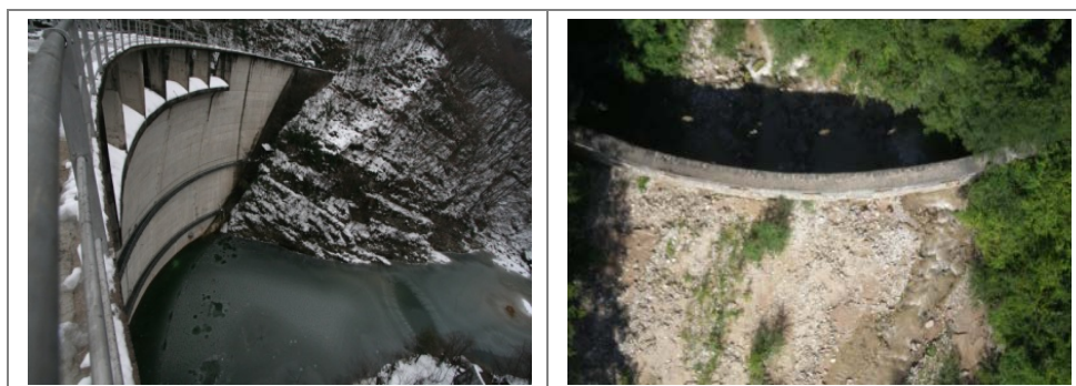
Figura 12.6 – Esempi di opere trasversali che possono determinare per i corpi idrici immediatamente a valle di esse le condizioni di cui al caso 4 previsto in Tabella 12.1 . A sinistra diga, a destra briglia di trattenuta non colmata.
