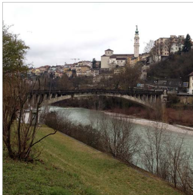
Figura A7.13 – Ponte del tipo 3 (Ponte della Vittoria, F. Piave presso Belluno).
