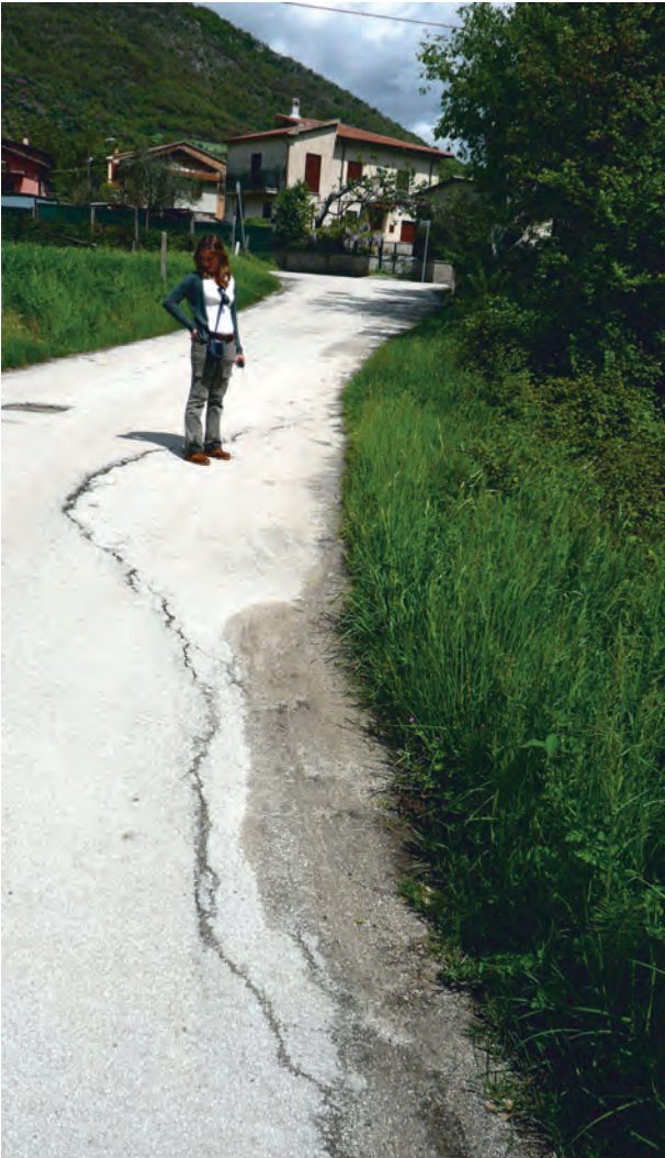
Fig. 2 - Riattivazione del Bozzo Burino durante il terremoto del 9 aprile 2009: si formarono alcune scarpate lungo il diametro ed una crepa interessò la strada.
