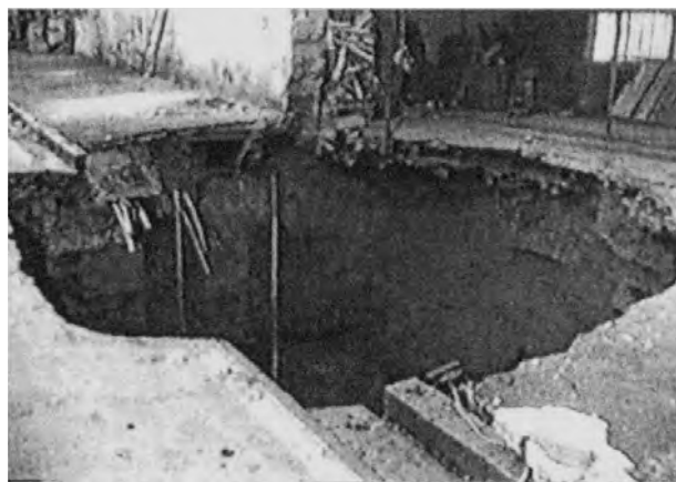
Fig. 12 – Sinkhole del 26 dicembre 1996 in via Miano (Napoli). – View of 26 th December 1996 sinkhole in Miano Street (Naples).
