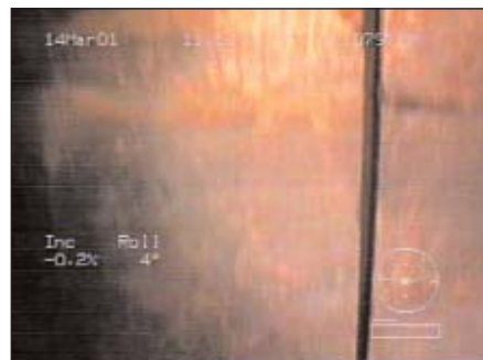
Fig. 24: Compensorio irriguo del Tufano: interno tubazione esistente in cemento amianto - giunto simplex con grande distacco
