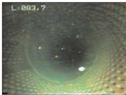
Fig.3: Compensorio irriguo del Tufano- videoispezione: interno pozzo irriguo DN 500 - vista filtro a ponte a - 83.7 m (con saldatura longitudinale filtro e testa-testa delle canne) - 83.7 m (con saldatura longitudinale filtro e testa-testa delle canne)
