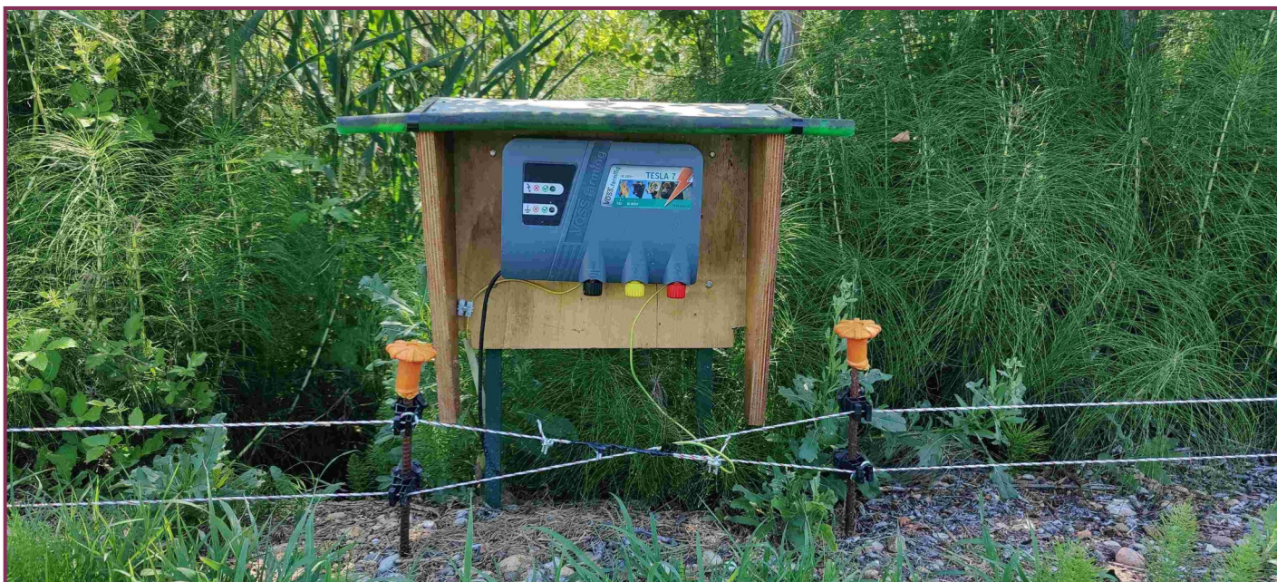
Figura 4. Il trasformatore del circuito elettrico protetto da una piccola tettoia (foto di A. Riviera).
